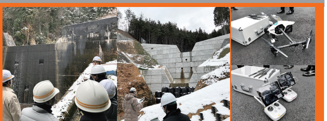
◆金勝川補助通常砂防事業現場 今後対策が必要とされる箇所について、ならびに金勝川補助通常砂防事業工事の概要等についての調査
